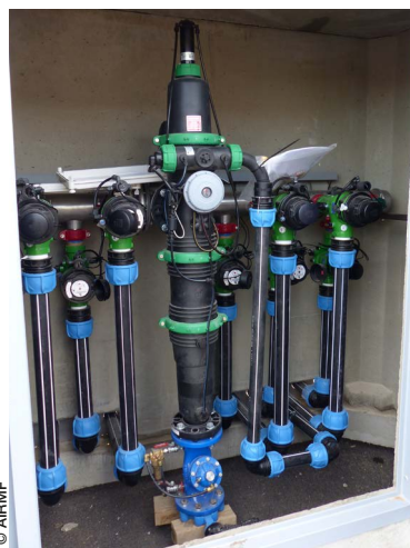
Chaque cabine connectée peut contenir jusqu'à 12 vannes par compteurs de type Bermad, ainsi que filtres et éléments de régulation.
